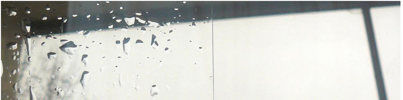
Kalvo asennettu ilman nestettä -> Kuplia.
